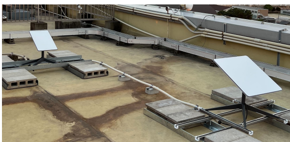
図1 Starlink アンテナの学内屋上設置図
