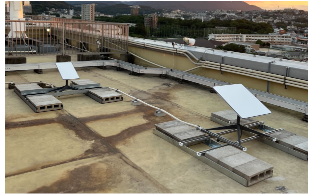
図 3: Starlink アンテナの設置環境 (手前 Business 用アンテナ, 奥 Residential 用アンテナ)
