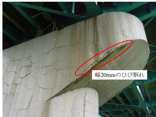
写真-2.10 幅 20mm のひび割れ発生箇所
