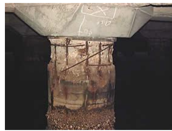
(b) 栈橋柱のコンクリート剥落状況
