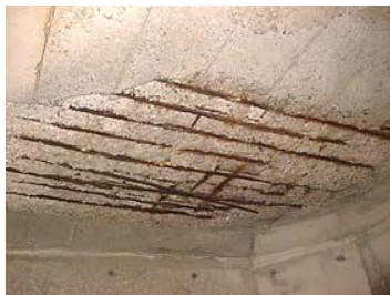
(a) 栈橋梁のコンクリート剥落状況
