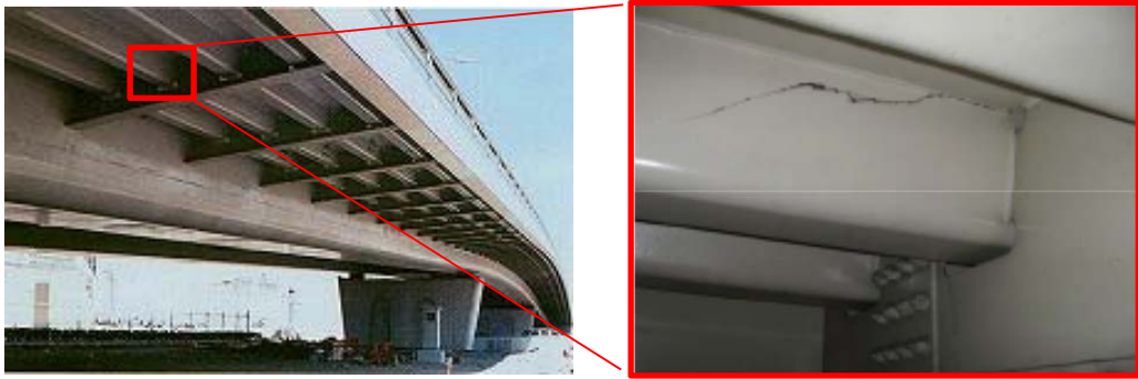
図 1.1 鋼床版溶接部の疲労損傷事例[3]
