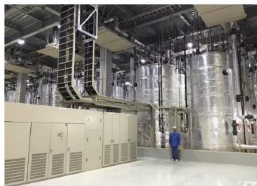
<建屋内の交直変換装置・電解液タンク>
